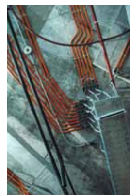
Instalaciones técnicas en cielo
